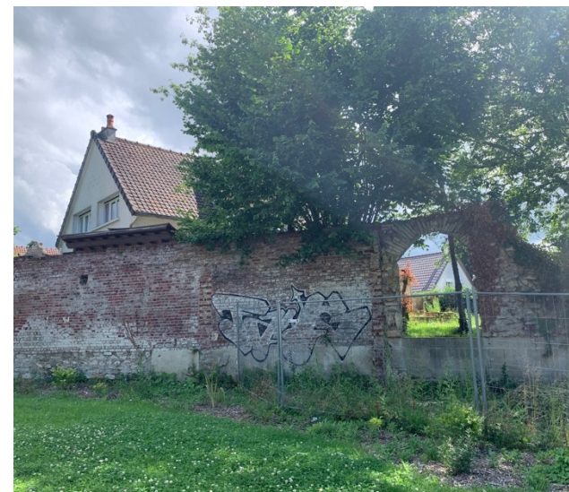
Mur ancien en mauvais état avenue Saint Ladre
